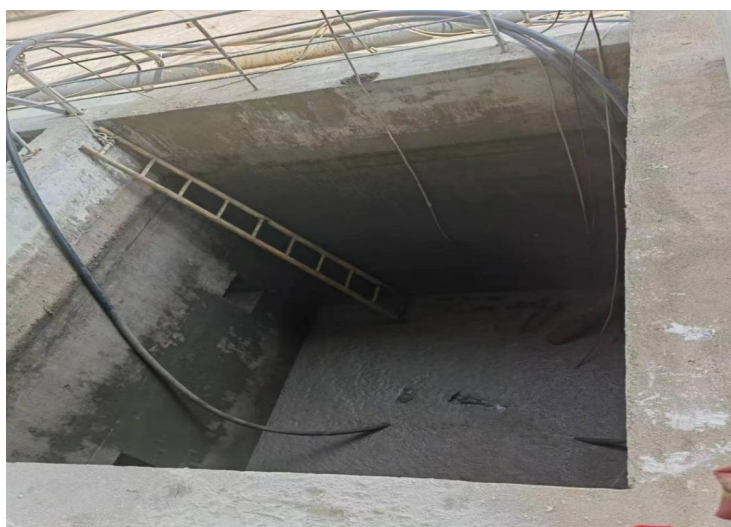
图 6 事故粪水收集池现场照片
