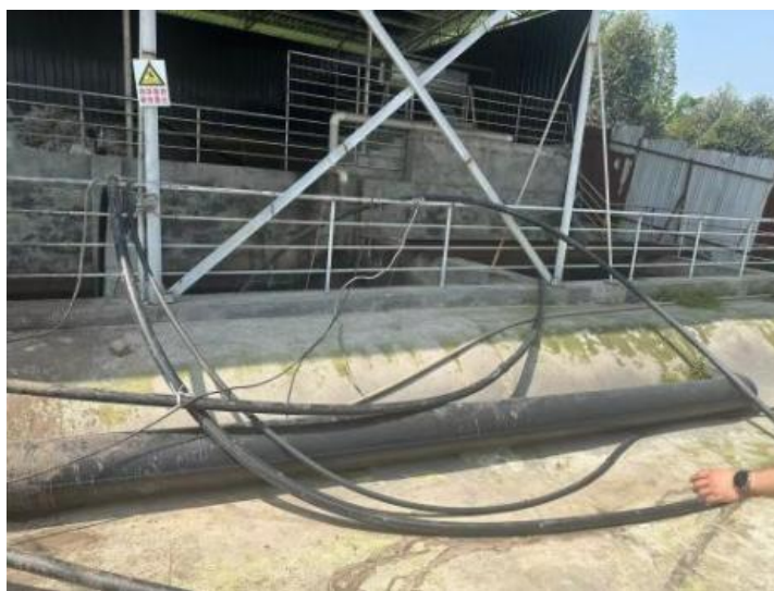
图 4 粪水处理区现场照片
